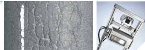
Risse und Oberflächenschäden
